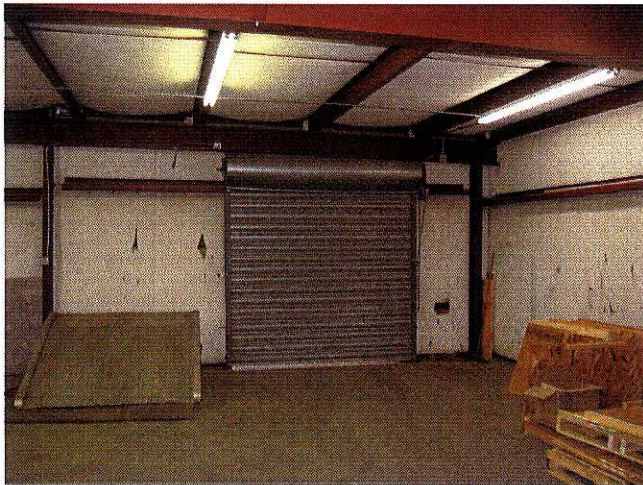
Dock high door
